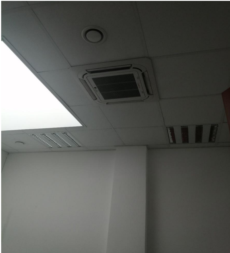
Zdjęcie nr 14 – klimakonwektor - pomieszczenie nr 2
