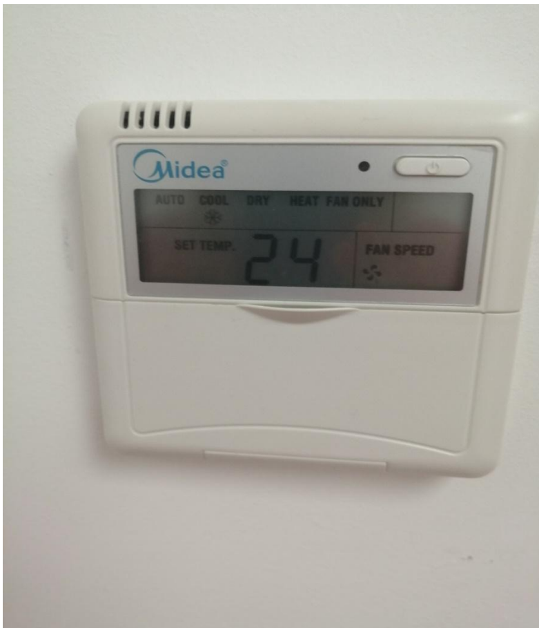
Zdjęcie nr 15 - panel obsługujący klimakonwektor – pomieszczenie nr 1, 2, 3
