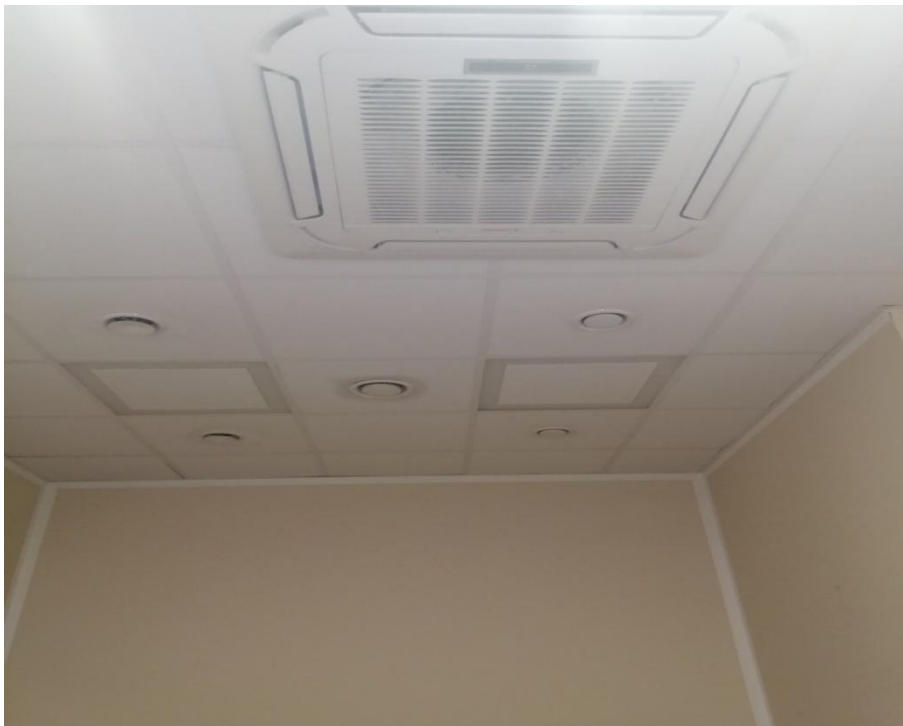
Zdjęcie nr 13 – klimakonwektor – pomieszczenie nr 3
